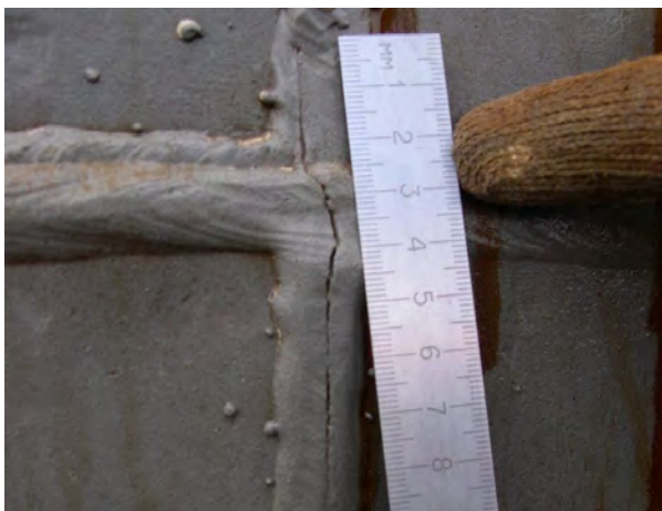
Рис. 1.8 - Тріщина в зоні зварного з'єднання резервуара, вид з зовнішньої сторони резервуара
