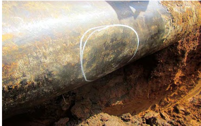
Рисунок 1.6. Дефект типу вм'ятини на трубопроді
