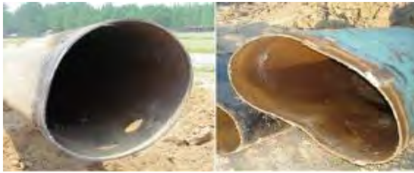
Рисунок 1.8. Дефект типу овальність на трубопроді
