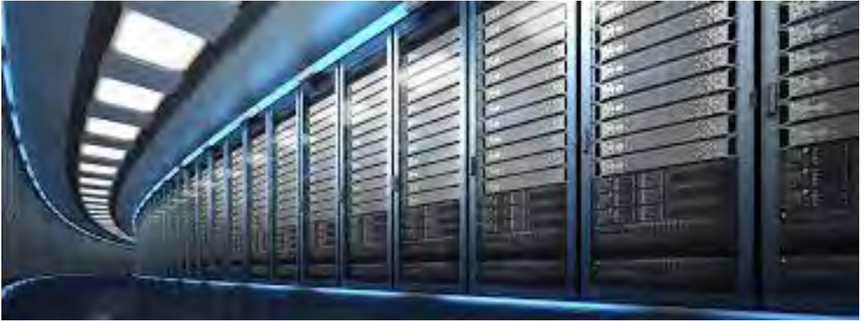
Рисунок 1.1. Зовнішній вигляд серверної кімнати
