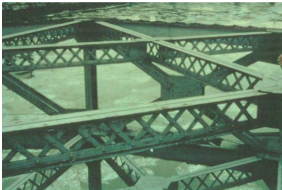
Рис.1.2. – Приклад мостової конструкції утвореної за допомогою різних типів балок та з'єднувальних пластин
